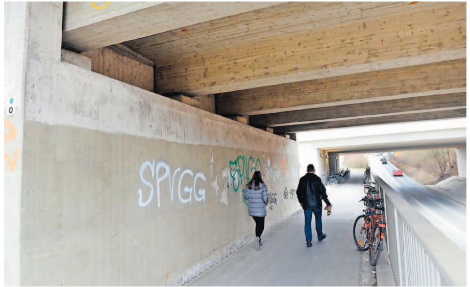
Keinen schönen Anblick bietet die Unterführung beim Bubenreuther Bahnhof. Zuständig ist die Deutsche Bahn, die von der Gemeinde bereits angeschrieben wurde. Foto: Klaus-Dieter Schreiter
