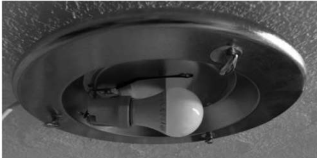
Bild 6: E27 LED Lampe in Deckenleuchte
