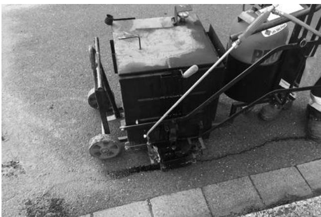
Verschließen der Straßenrisse
