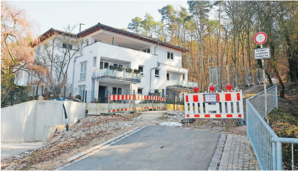
Der Waldweg wurde beim Bau des neuen Wohnblocks abgegraben und musste gesperrt werden, die Parkplätze sind durch Baumaterial verstellt: Nun will die Gemeinde zivilrechtlich gegen die Baufirma vorgehen. F.: Klaus-Dieter Schreiter
